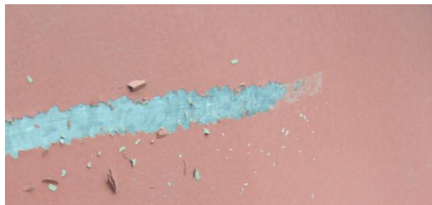
Bild till höger: Dålig vidhäftning. Avrensas totalt!
